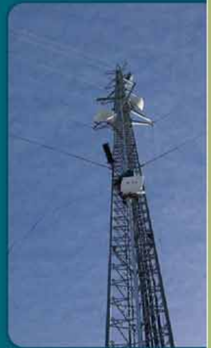
L'installation du routeur sans fil à distance d'Eion en Équateur. L'élaboration du prototype de la prochaine génération de routeurs intelligents d'Eion est appuyée par le Programme d'alliance de Precarn-CTIO.
