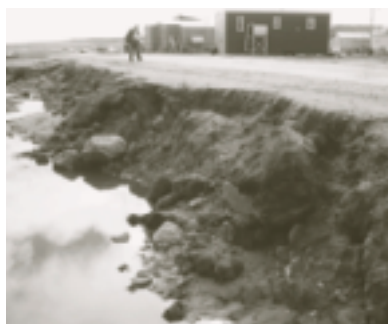
Érosion de pergélisol ayant causé l'affaissement d'une route
