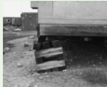
La fonte du pergélisol entraîne un déplacement inégal de la fondation de ce bâtiment.
