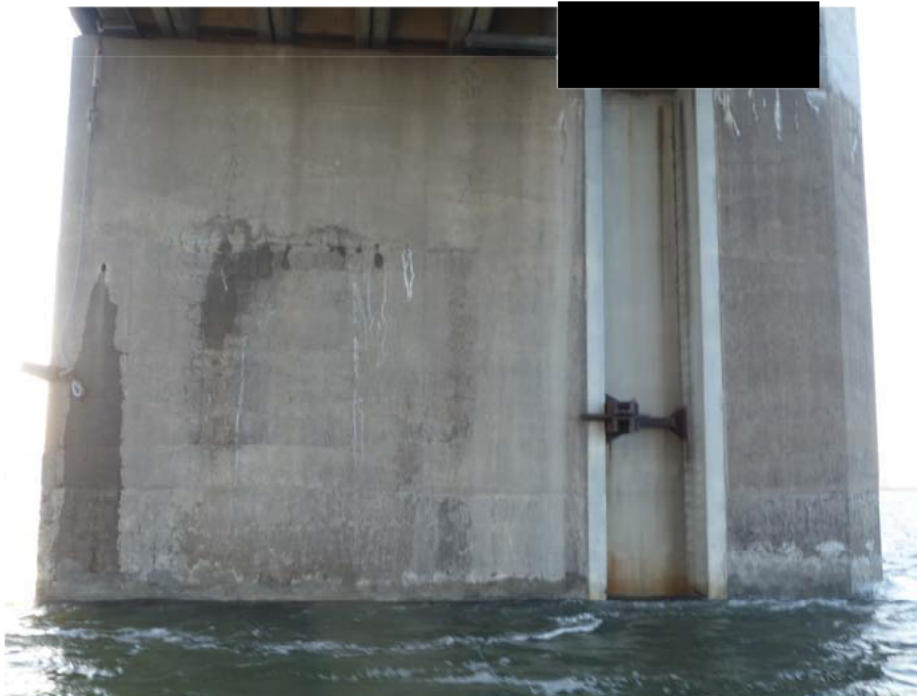
Figure 87 : Paroi gauche / Pile 18 (ES18-PG)
