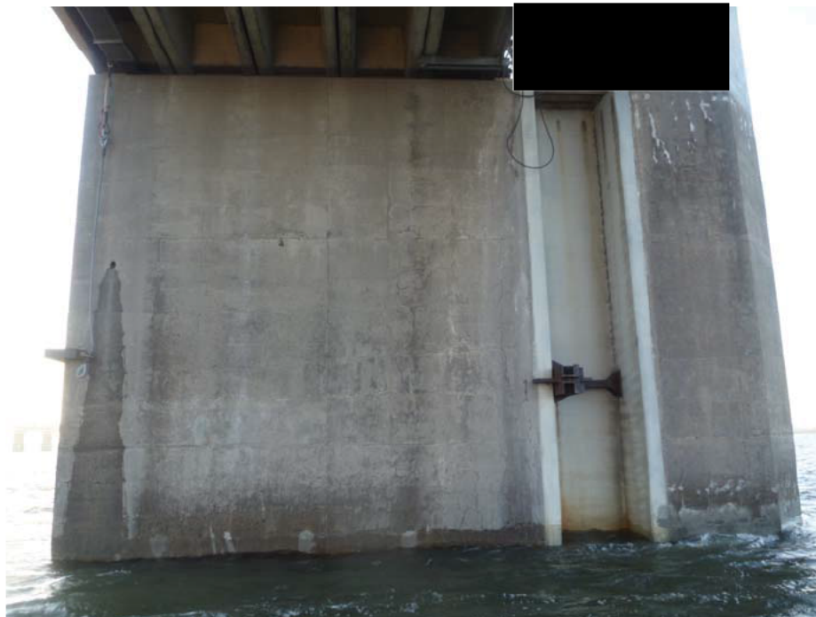
Figure 83 : Paroi gauche / Pile 17 (ES17-PG)
